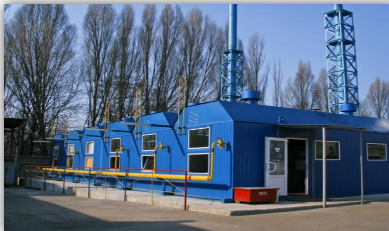
Блочно-модульная котельная установка
